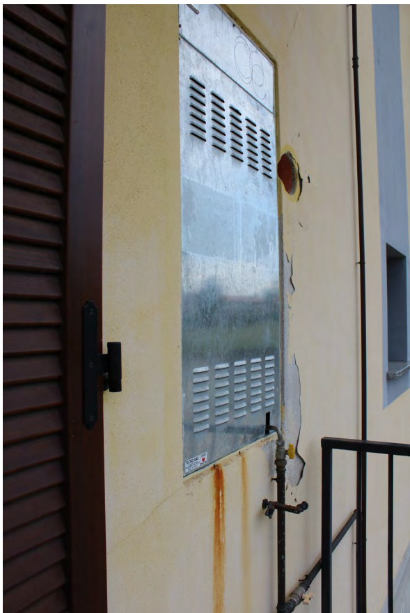
Caldaia su balcone
