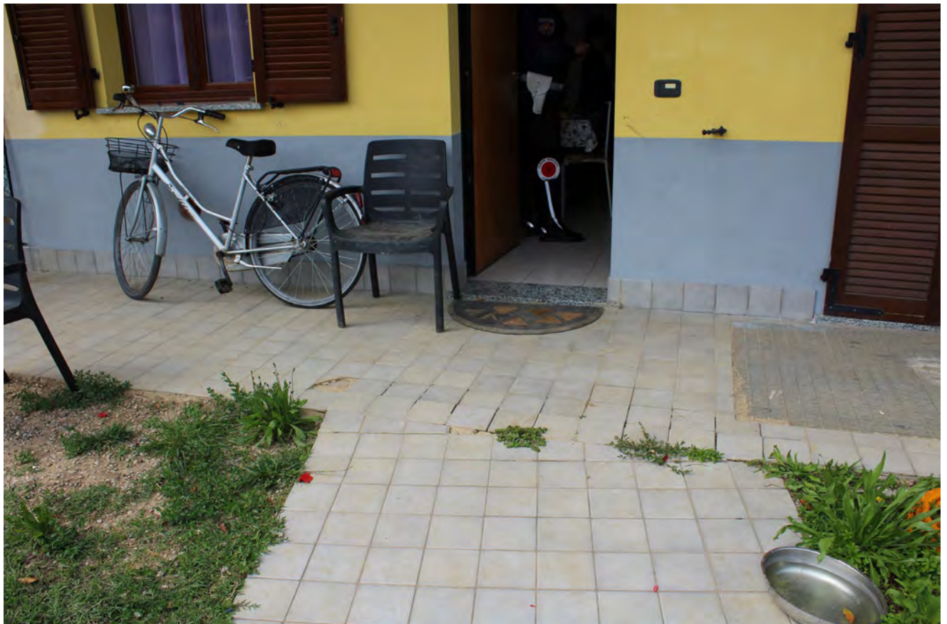
Particolare piastrelle sollevate davanti ingresso
