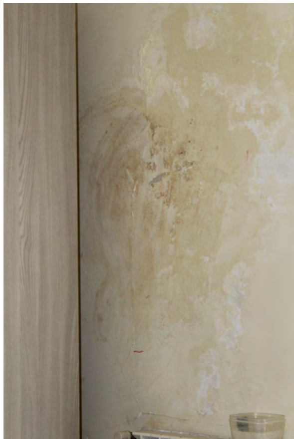
Infiltrazioni camera in corrispondenza caldaia
