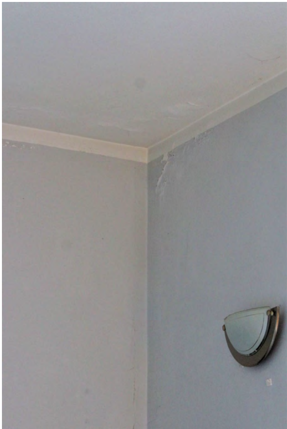
Infiltrazioni angolo soggiorno
